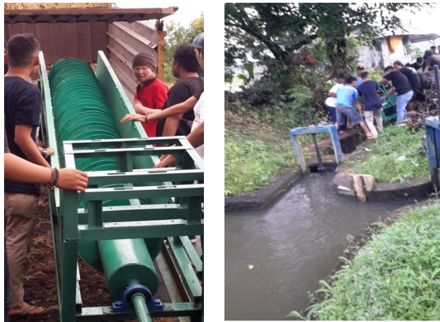
Foto Pemasangan Turbin pada Saluran Irigasi Desa Talawaan
