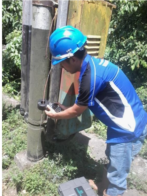
Gambar 3.3 Pengukuran pentanahan trafo Bebal 2
