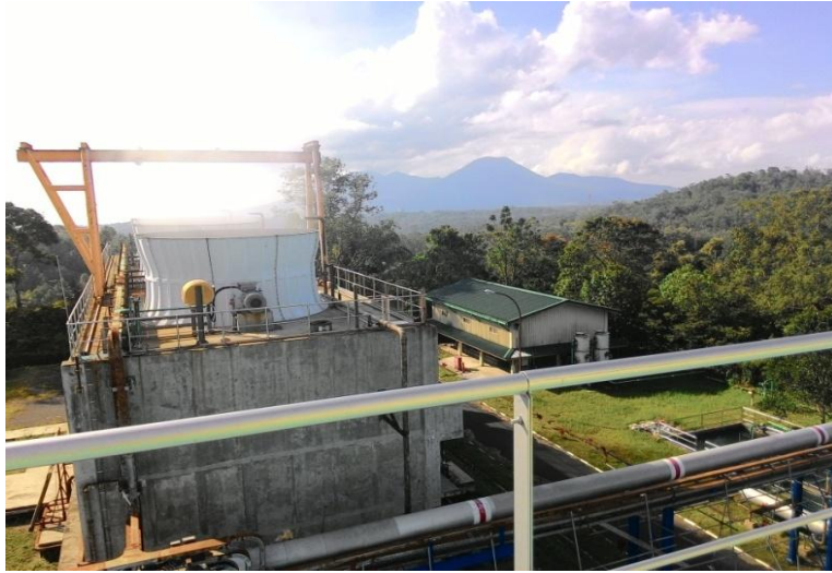
Gambar 2.24 Penampang samping bagian atas cooling tower unit 1.
