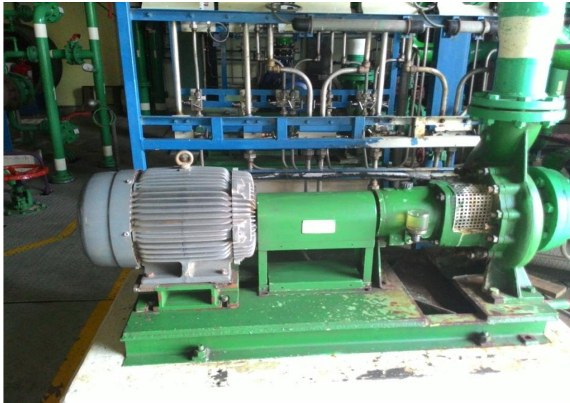
Gambar 2.27 SCWP Unit 1 PLTP Lahendong
