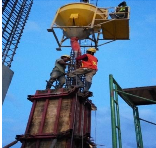
Gambar 5.9 Penuangan beton segar dari bucket ke cetakan kolom diangkat menggunakan mobile crane
