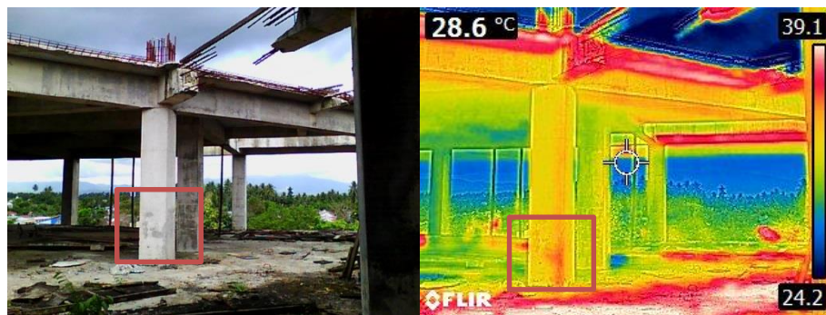
Gambar 4.18 Foto visual dan thermal imaging pada kolom lantai 3
