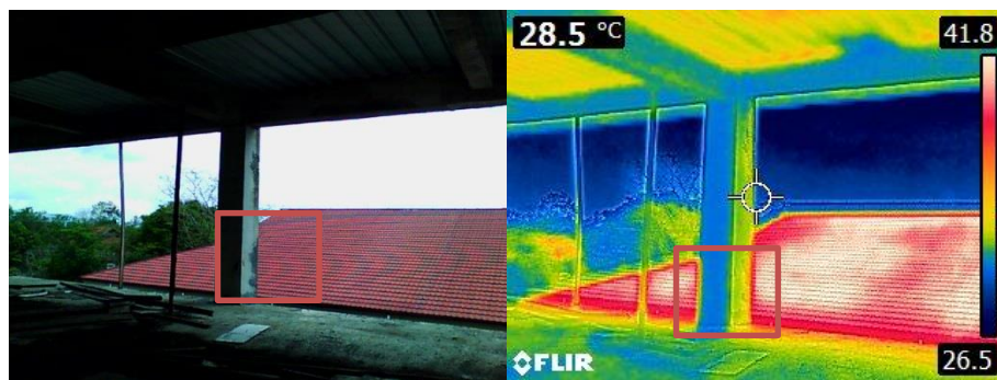
Gambar 4.17 Foto visual dan thermal imaging pada kolom lantai 2
