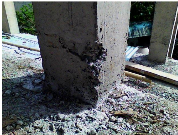
Gambar 4.21 Kerusakan kolom pada bangunan Masjid Al-Muhajirin
