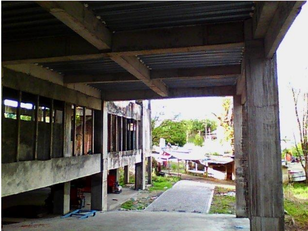
Gambar 4.7 Tampak lantai dasar & lantai basement struktur bangunan Pendidikan Terpadu Politeknik Negeri Manado
