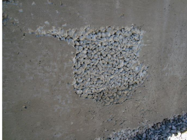
Gambar 2.2 Voids pada beton
