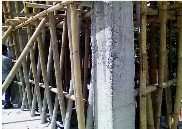
Gambar 4.23 Kerusakan kolom pada bangunan Masjid Al-Muhajirin
