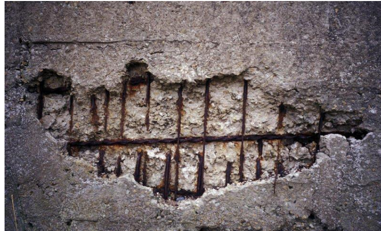
Gambar 2.3 Scalling pada beton
