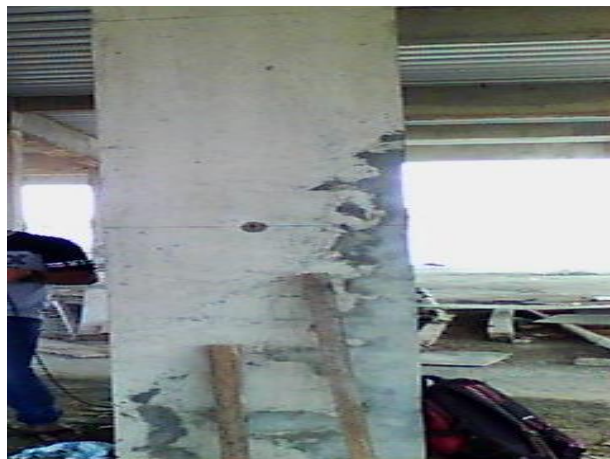
Gambar 4.24 Kerusakan kolom pada bangunan Kuliah Pendidikan Terpadu Politeknik Negeri Manado
