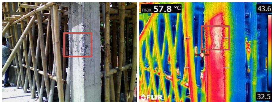
Gambar 4.14 Foto visual dan thermal imaging pada kolom lantai !
