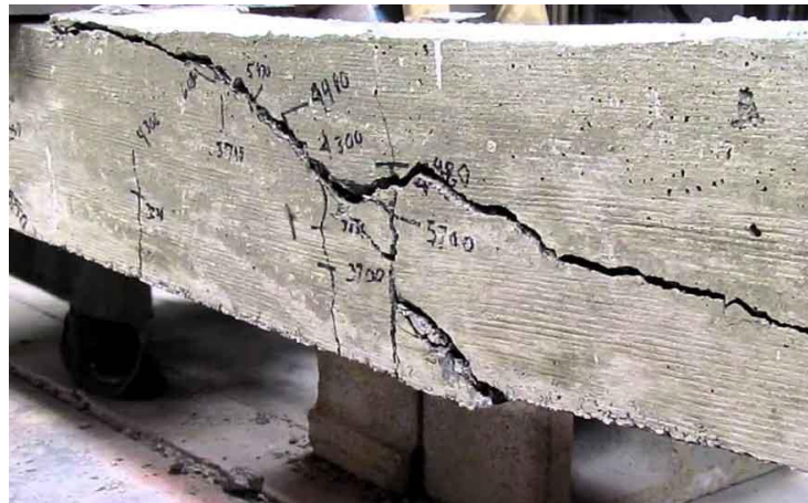
Gambar 2.1 Retak pada beton
