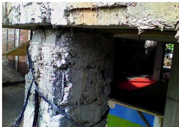
Gambar 4.22 Kerusakan kolom pada bangunan Masjid Al-Muhajirin
