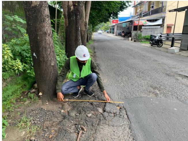
Gambar K-5. Pengukuran Kerusakan Pengausan
