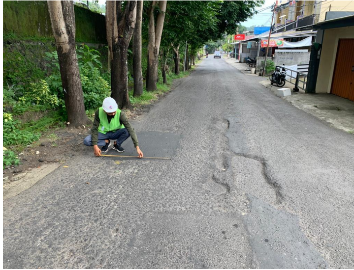
Gambar K-2. Pengukuran kerusakan Tambalan
