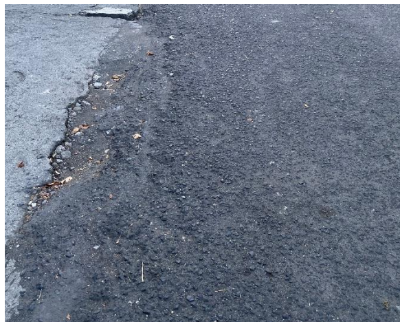
Gambar G-5. Kerusakan Sungkur
