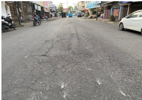
Gambar G-2. Kerusakan Retak Kulit Buaya
