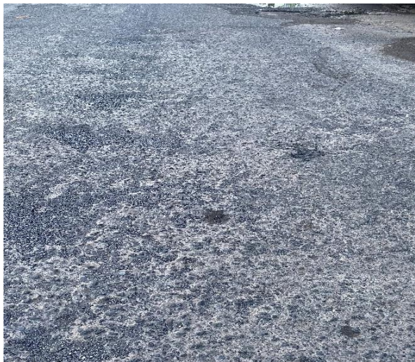
Gambar G-9. Kerusakan Pengausan
