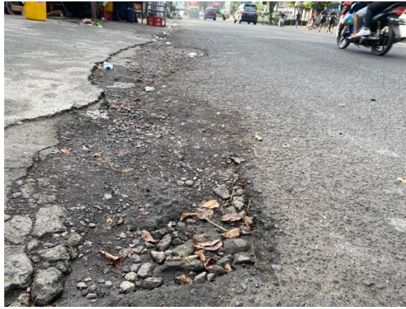
Gambar G-4. Kerusakan Retak Pinggir
