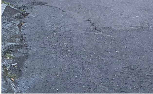
Gambar G-11. Kerusakan Pengembangan
