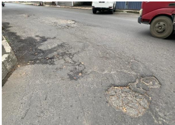
Gambar G-3. Kerusakan Amblas
