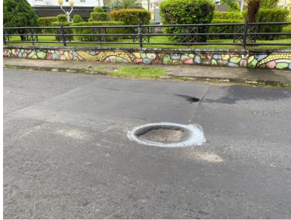
Gambar G-1. Kerusakan Lubang
