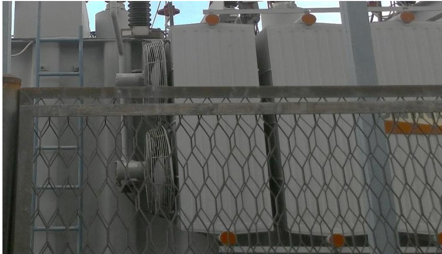
Gambar 3.6. Pendingin pada Transformator.
