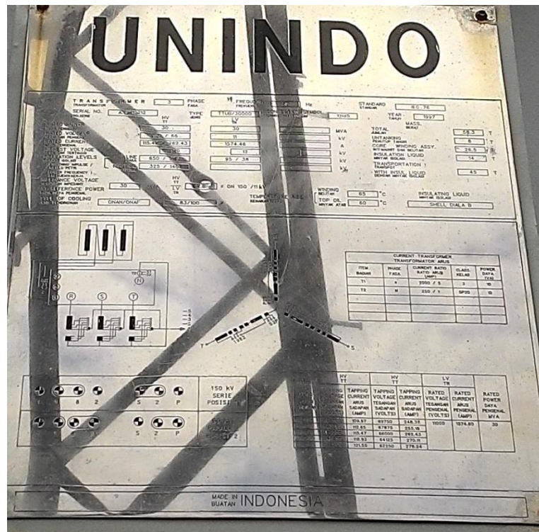
Gambar 3.12. Name Plate Transformator PLTP Lahendong unit 1.
