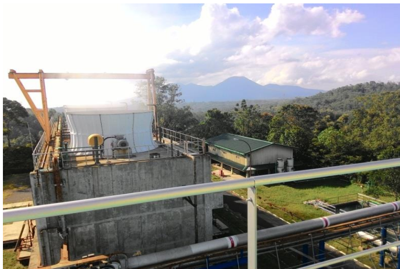
Gambar II.5. Penampang samping bagian atas cooling tower unit 2. Tampak uap keluar dari permukaan cooling tower menuju ke udara bebas.
