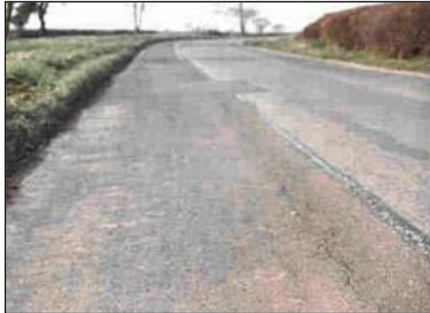
Gambar 2.9. Retak Sambungan Pelebaran Jalan
