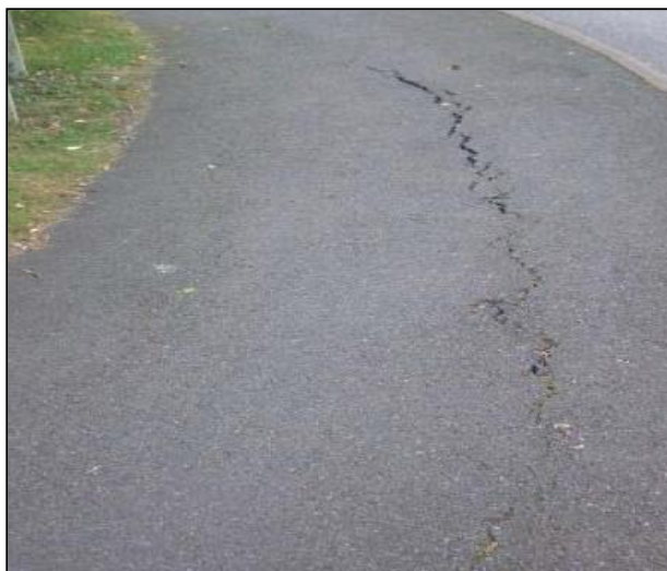
Gambar 2.8. Retak Sambungan Bahu
