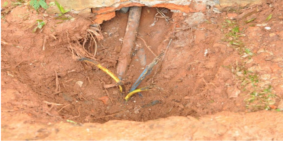
Gambar kerusakan pada kabel tanah
